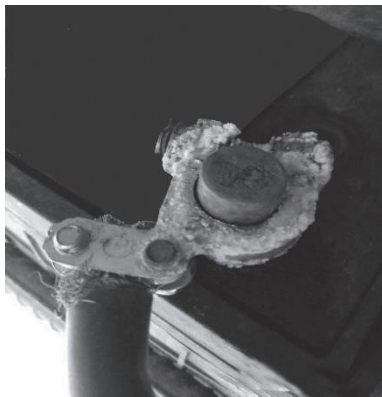
图 1-2-16 极柱受到氧化、腐蚀
