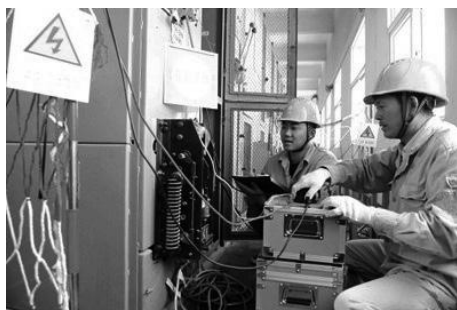
图 1-10 企业电气设备定期运行管理
