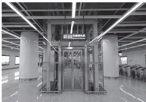
图 1-2-4 站内无障碍电梯设备
