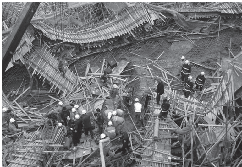
图 1-1 贵阳国际会议展览中心“3·14”事故现场
