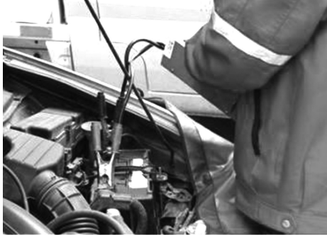
图1-2-14 检查蓄电池安装情况
