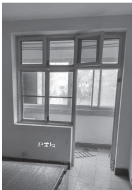
矮墙不能全拆
