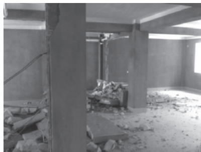
承重墙不能拆
