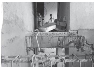
墙体、梁、柱、楼板中的钢筋不能动
